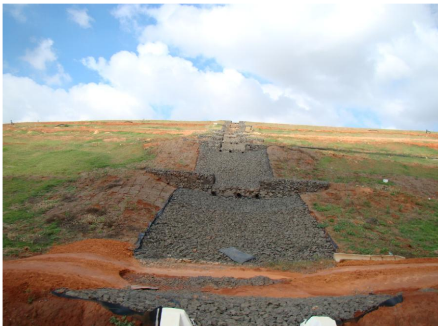
Figura 2. Canaleta para captação de águas de chuvas
